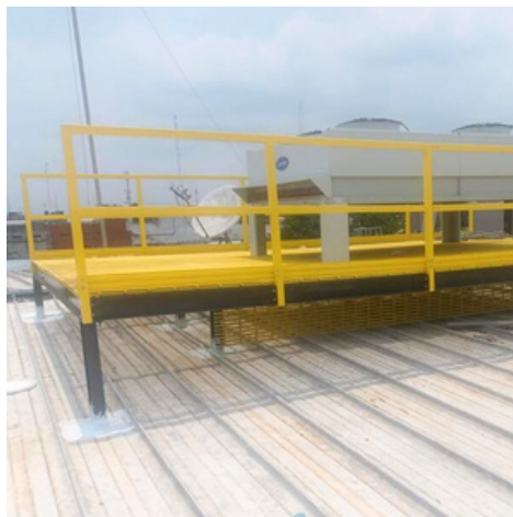
BASES PARA SISTEMA DE AIRE ACONDICIONADO
