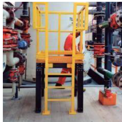
PLATAFORMA PARA ACCESO A VÁLVULAS
