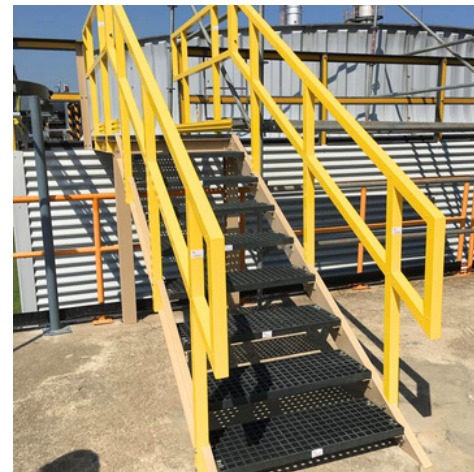
PLATAFORMA DE ACCESO A TORRES DE ENFRIAMIENTO
