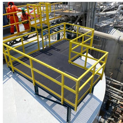
TANQUE DE ALMACENAMIENTO
